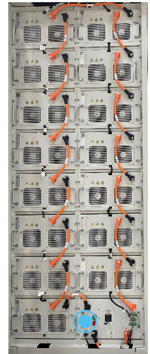
Bateria stojak z 15 modułami
